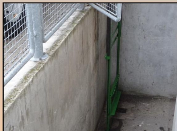
Elevator lang, til kælderskakt
