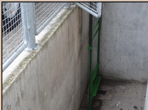
Elevator lange, aus Kellerschacht.
